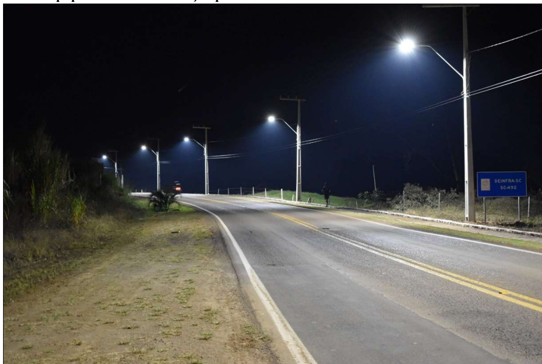
Figura 49 –Equipamentos de iluminação pública.
