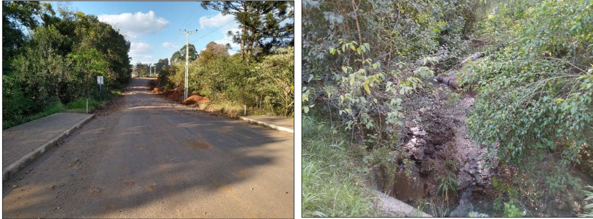
Figura 85 – Situação atual do ponto de atenção 04.
